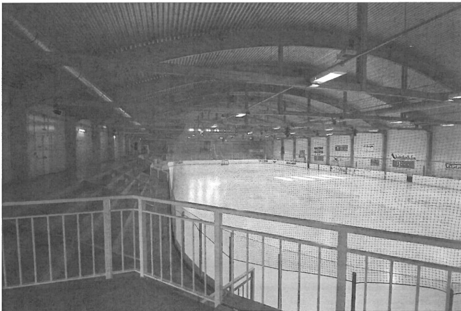
3. kép: Légcsatorna hálózat a Jégcsarnokban
