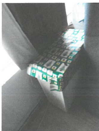
16. konvektor (nincs bekötve)
