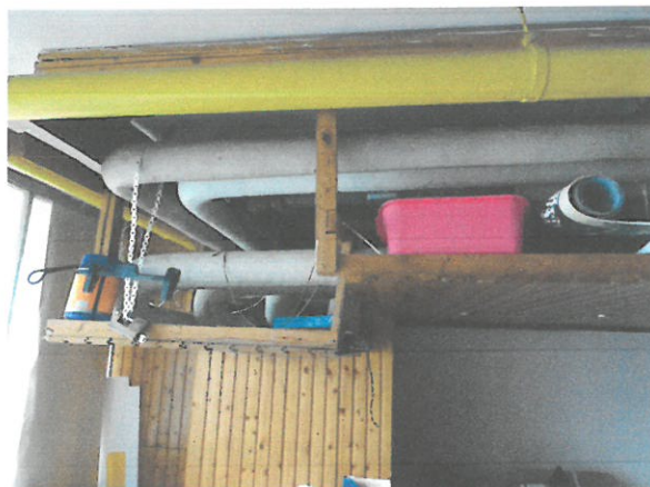
07. strangvezetékek a földszinten
