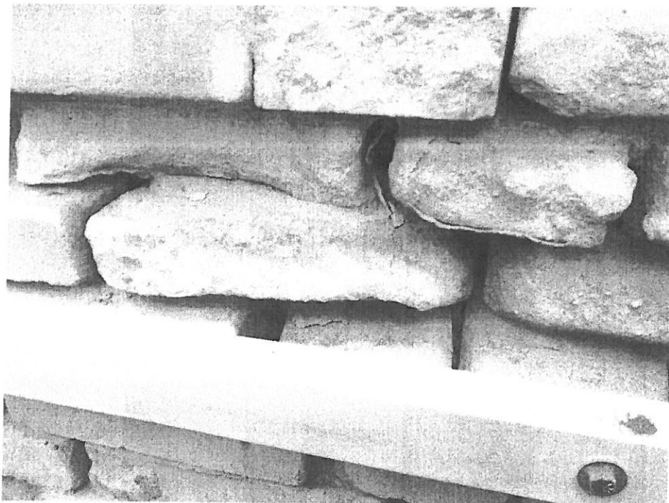
2. kép: Szétázott lábazat a pékség felől
