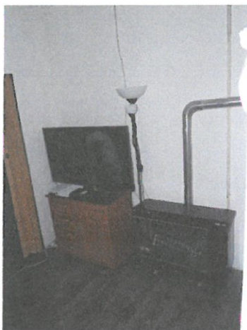
08. kéményre kötött gázkonvektor
