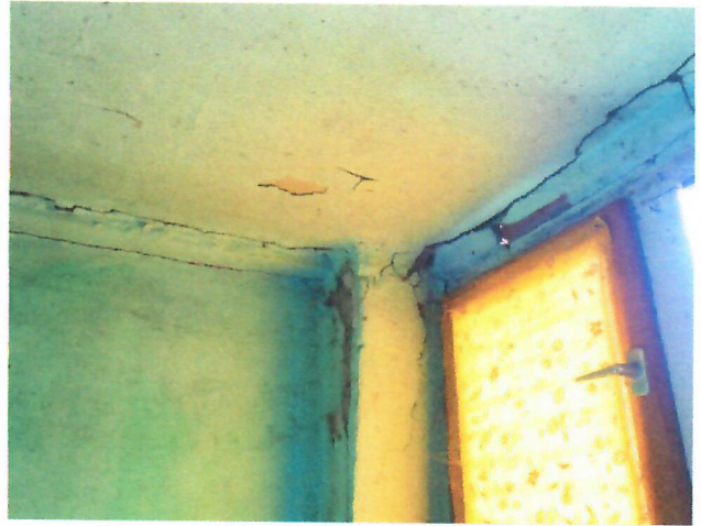
07. repedések a mennyezeten
