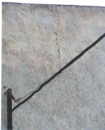
05. repedezett külső falazat
