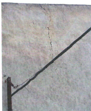
05. repedezett külső falazat
