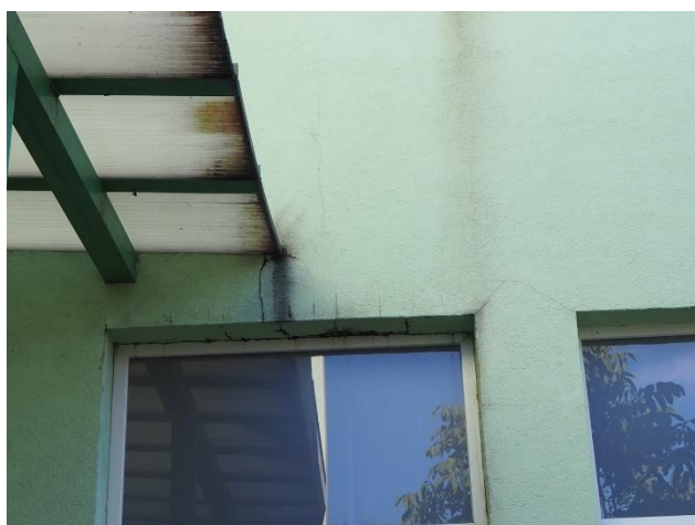
10. terasz alatti repedés
